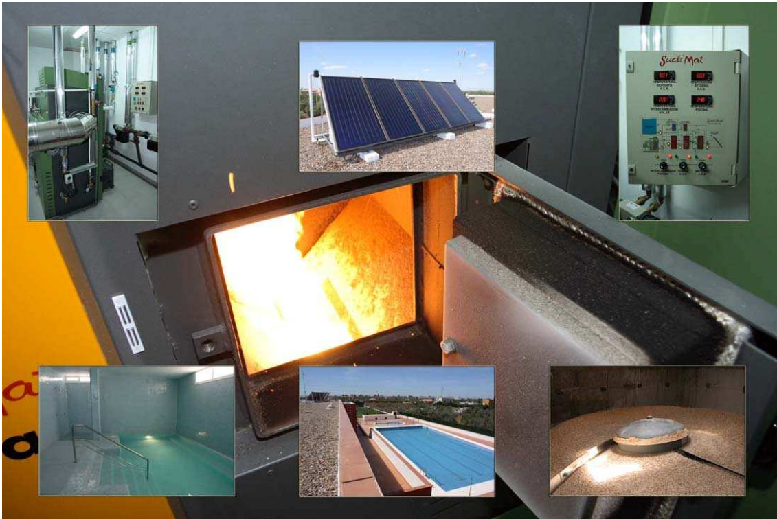
(Foto: vista de las diferentes instalaciones, caldera, placas solares, silo de biomasa, controladores y piscinas.)
